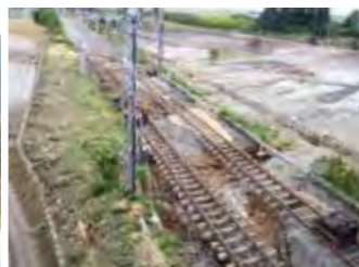
▲写真1 2019年10月14日 線路を支える道床が流された東武日光線静和駅付近
