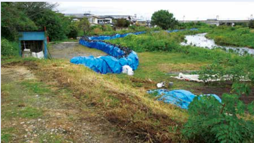
巴波川沼和田地区の護岸工事が最優先区間として整備されます。
