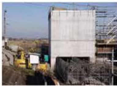
与良川統合排水機場
